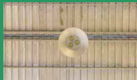
โคมไฟที่ใช้หลอด LED ซึ่งใช้พลังงานน้อยกว่าหลอดแบบเดิมแต่ยังคงความสว่างเท่าเดิม จากโครงการเปลี่ยนหลอดไฟแสงสว่างคลังสินค้า
