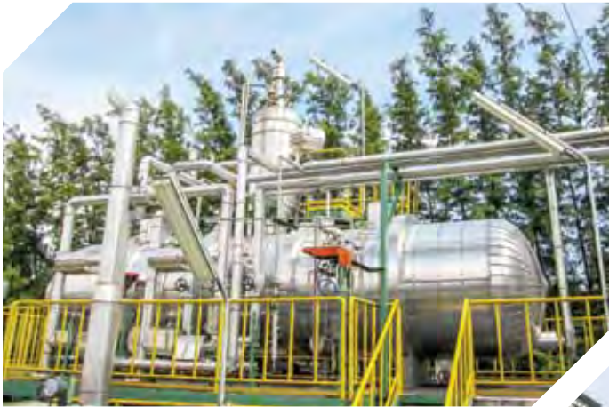
Deaerator อุปกรณ์ที่ใช้ในการเตรียมคุณภาพน้ำ ก่อนเข้าสู่ถัง Steam Flash Drum
