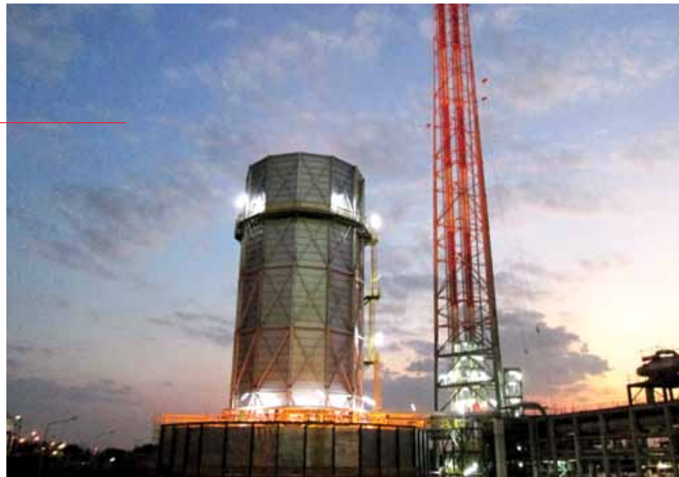
หอเผาไร้ควัน (Enclosure Ground Flare) นวัตกรรม Eco Innovation ของ เอสซีจี เคมิคอลส์
