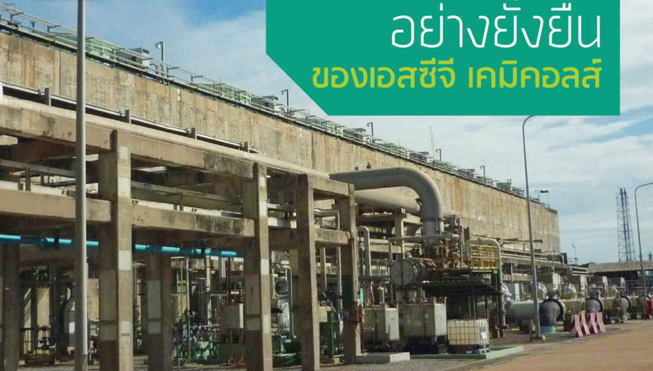
การเพิ่มรอบหมุนเวียนของน้ำหล่อเย็นในหอหล่อเย็น (Cooling Tower)
