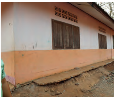
ห้องสมุดโครงสร้างอาคารทรุดตัวแตกร้าว
