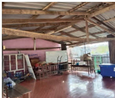
โรงอาหารชำรุดมุงฟุ้งและพื้นที่คับแคบไม่เพียงพอกับการใช้งาน
