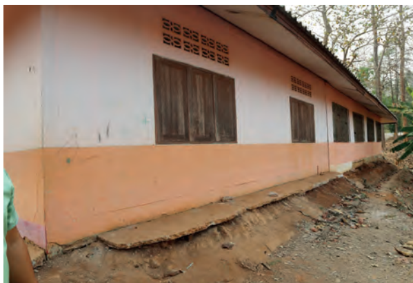
ห้องสมุดโครงสร้างอาคารทรุดตัวแตกร้าว
